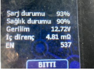
Elektrik donanımı/Pano, Akü > Test Sonucu
