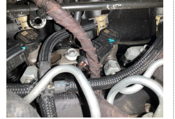
Motor, Motor/Yakıt sistemi > Sızdırıyor
