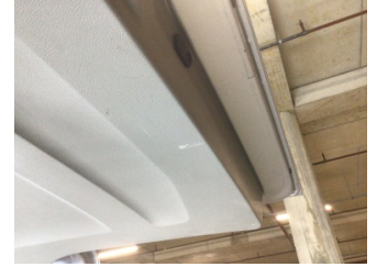
Döşemeler/Kapaklar, Döşemeler/Kapaklar > Çizik
