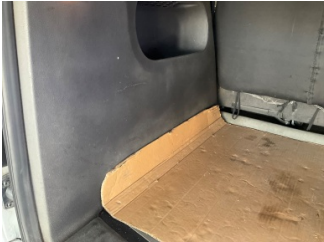
Döşemeler/Kapaklar, Döşemeler/Kapaklar > Çizik
