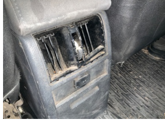
Kalorifer/Klima, Havalandırma ızgarası > Hasarlı
