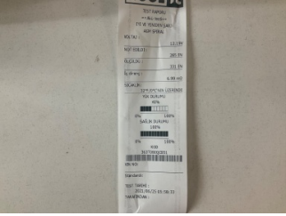
Elektrik donanımı/Pano, Akü > Test Sonucu
