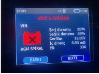
Elektrik donanımı/Pano, Akü > Test Sonucu
