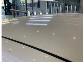
Tavan, Tavan > Dolu Hasarlı
