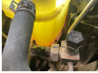
Motorsoğutması, Soğutma sıvısı > Eksik
