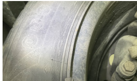
Tekerlek seti > Çatlak
