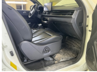
Döşemeler/Kapaklar, Döşemeler/Kapaklar > Kirlenmiş
