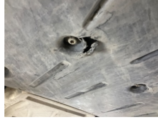
Motor, Alt muhafaza > Hasarlı
