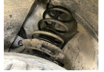
Ön aks, Amortisör körüğü, sağ > Hasarlı
