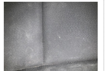
Döşemeler/Kapaklar, Döşemeler/Kapaklar > Yakıcı Madde ile Zarar Görmüş
