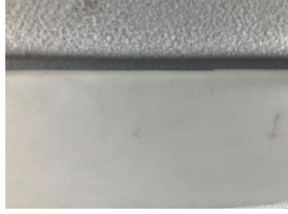
Döşemeler/Kapaklar, Döşemeler/Kapaklar > Kirlenmiş
