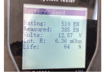
Elektrik donanımı/Pano, Akü > Test Sonucu
