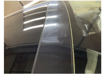
Tavan, Sunroof çerçeve/kasa > Hasarlı
