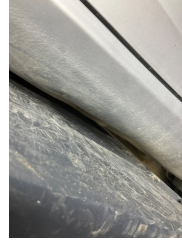
Marşbiyel, sol, Marşbiyel, sol > Hasarlı
