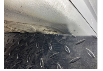
Marşbiyel, sol, Marşbiyel, sol > Hasarlı
