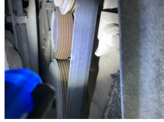
Motorsoğutması, Kayış > Çatlak
