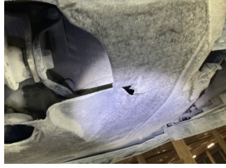
Motor, Alt muhafaza > Hasarlı
