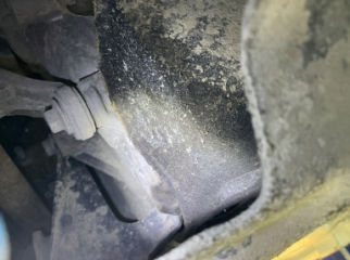
Motor, Motor > Yağ Kaçağı
