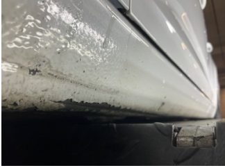
Marşbiyel, sol, Marşbiyel, sol > Boyası Atmış
