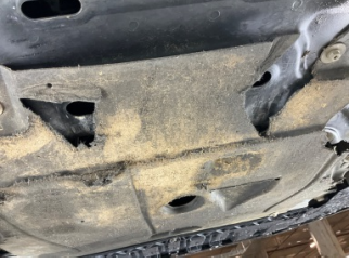
Motor, Alt muhafaza > Hasarlı
