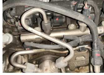
Motor, Külbütör kapağı > Yağ Kaçağı
