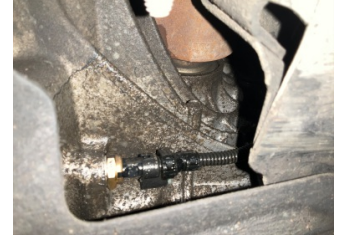
Şanzıman, Şanzıman > Yağ Kaçağı
