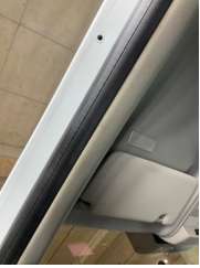
Döşemeler/Kapaklar, Döşemeler/Kapaklar > Kirlenmiş
