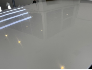
Tavan, Tavan > Dolu Hasarı
