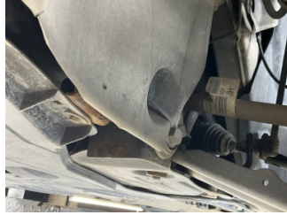
Çamurluk, sol, Çamurluk, sol > Sabitlemesi Hatalı
