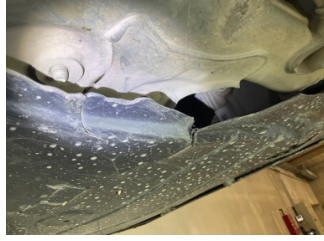
Motor, Alt muhafaza > Hasarlı
