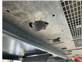
Kaporta, Muhafaza, orta > Hasarlı
