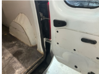
Döşemeler/Kapaklar, Döşemeler/Kapaklar > Çizik
