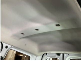
Döşemeler/Kapaklar, Tavan döşemesi > Onaysız
