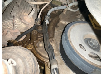
Motor, Motor > Yağ Kaçağı
