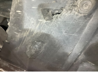
Motor, Alt muhafaza > Hasarlı
