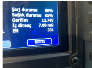
Elektrik donanımı/Pano, Akü > Test Sonucu
