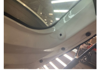
Döşemeler/Kapaklar, Pandizot > Eksik
