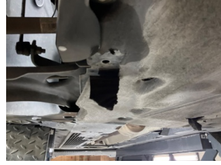
Motor, Alt muhafaza > Hasarlı
