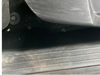
Döşemeler/Kapaklar, Döşemeler/Kapaklar > Yakıcı Madde İle Zarar Görmüş
