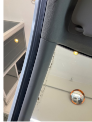
Döşemeler/Kapaklar, Döşemeler/Kapaklar > Yakıcı Madde ile Zarar Görmüş
