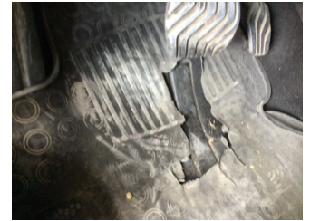
Taban, Paspaslar > Hasarlı
