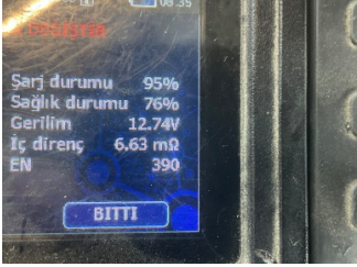
Elektrik donanımı/Pano, Akü > Test Sonucu
