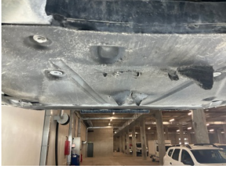
Motor, Alt muhafaza > Hasarlı
