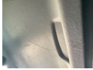
Döşemeler/Kapaklar, Döşemeler/Kapaklar > Kirlenmiş
