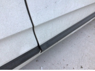
Kapı, sağ ön, Kapı, sağ ön > Sabitlemesi Hatalı
