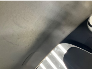
Döşemeler/Kapaklar, Tavan döşemesi > Deforme Olmuş
