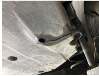
Kaporta, Muhafaza, arka > Hasarlı
