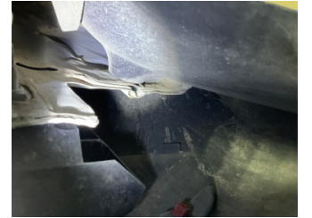
Arka bölüm, Arka sac/panel > Hasarlı
