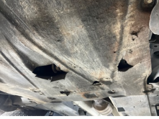
Motor, Alt muhafaza > Hasarlı
