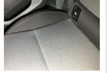
Döşemeler/Kapaklar, Döşemeler/Kapaklar > Yakıcı Madde Ile Zarar Görmüş
