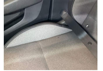
Döşemeler/Kapaklar, Döşemeler/Kapaklar > Yakıcı Madde Ile Zarar Görmüş
