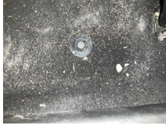
Döşemeler/Kapaklar, Döşemeler/Kapaklar > Yakıcı Madde Ile Zarar Görmüş
