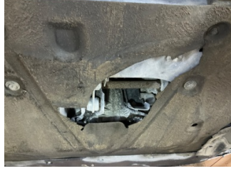
Motor, Alt muhafaza > Hasarlı
