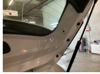
Döşemeler/Kapaklar, Pandizot > Hasarlı
