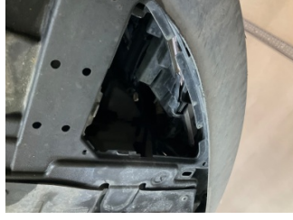
Tampon, ön, Tampon koruyucu sol > Eksik
